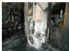
本件燃えた室外機
